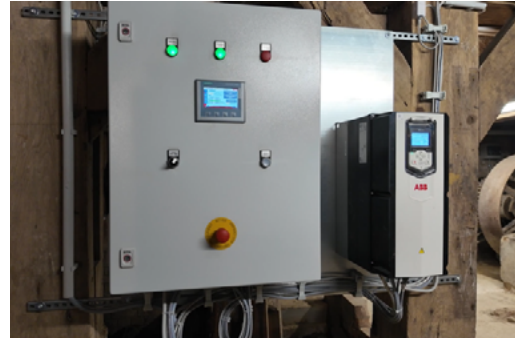
Schaltschrank und Umrichter
