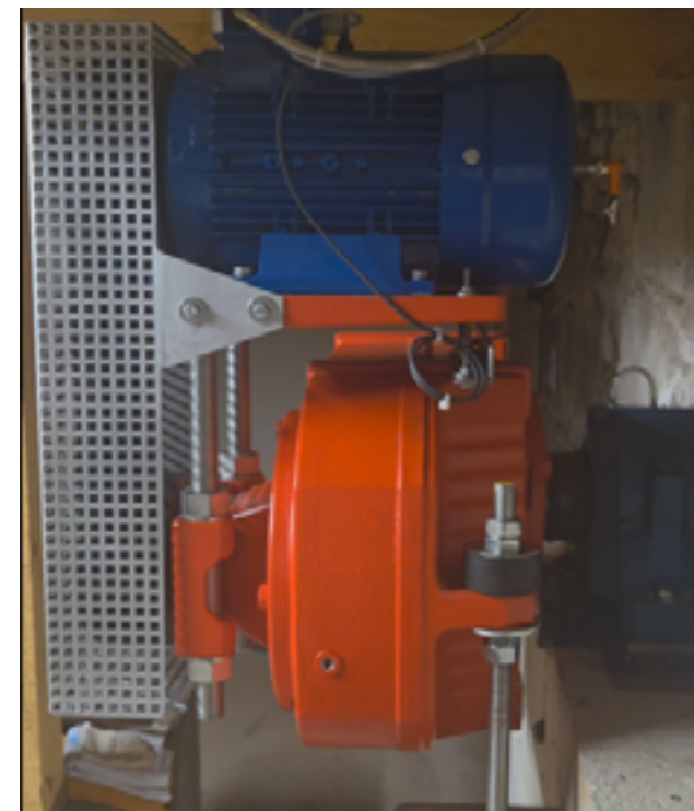
Getriebe, Riemen, Generator
